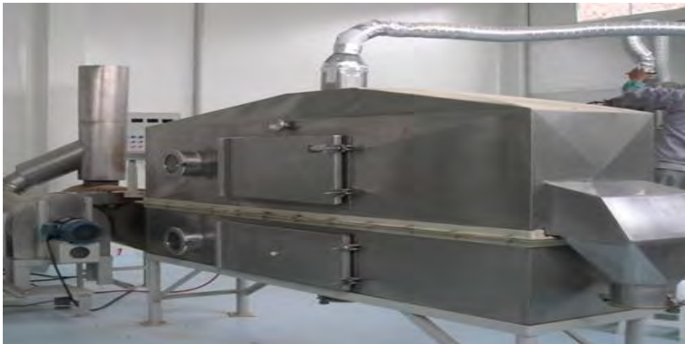
Túnel de secado
